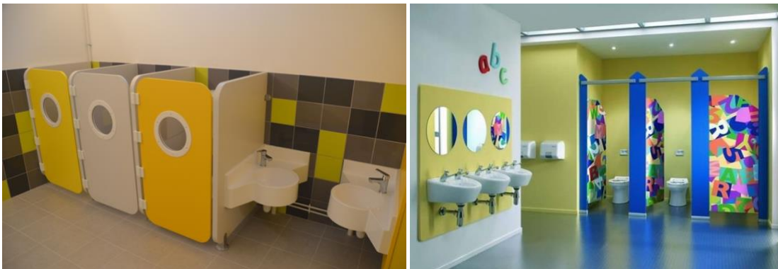
FIGURE 18 IMAGE DE REFERENCE - AMENAGEMENT SANITAIRES AVEC/SANS CONTROLE VISUEL DU PARENT SELON L'AGE DE L'ENFANT
